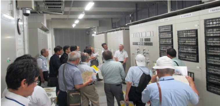
変電所の概要・配電盤説明 地下鉄東山線を支える変電所のひとつとしての機能、 変電所の概要・構成をお聞きしました。
