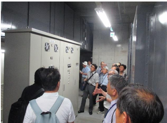
送風機制御盤 直流き電設備・高圧配電設備などに併せて、 地下式変電所特有の送風機設備についても 説明をいただきました。
