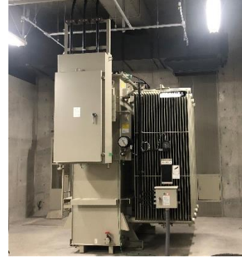
高圧配電用変圧器 4500kVAの主要変圧器
