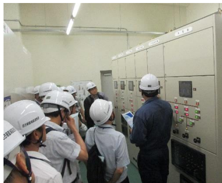
変電所の概要・配電盤説明 変電所の構成、安全・安心な電力供 給に向けた隣接変電所との電力連系 などについてもお聞きしました。
