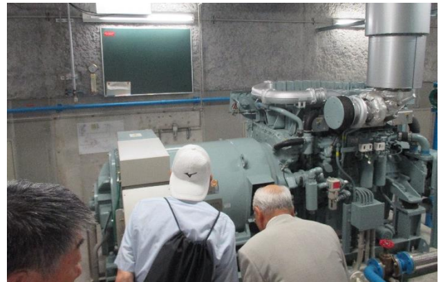
非常用発電設備 停電時に駅構内に供給されます。地下に設置 されていることから、黒煙除去装置・排気冷却 装置が付帯されていました。
