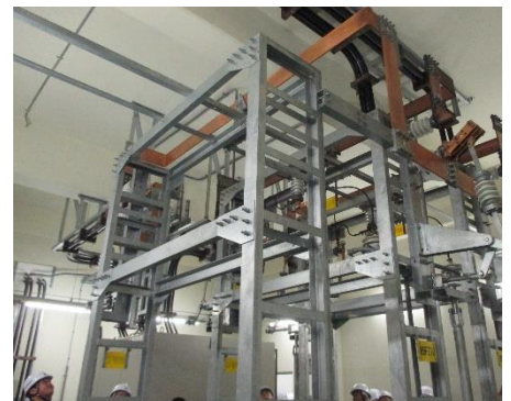
開閉設備 変電所を構成する様々な機器につ いて説明をいただきました。
