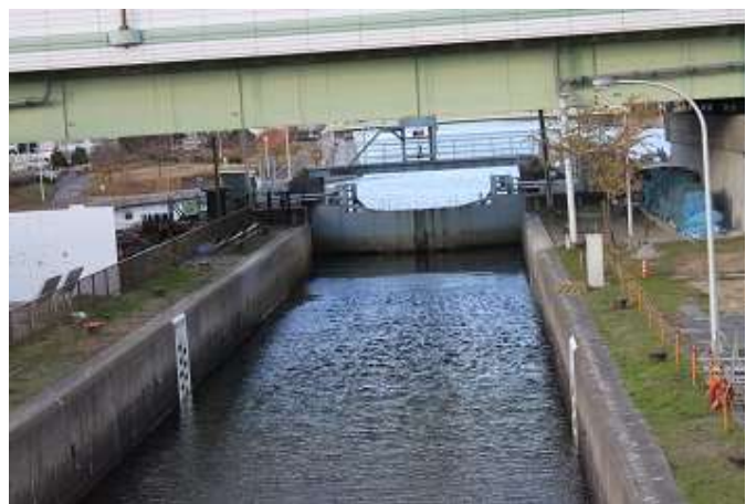
中川運河 中川口閘門 (市内側) 市内側の水門を開き、市内側水位に調整
