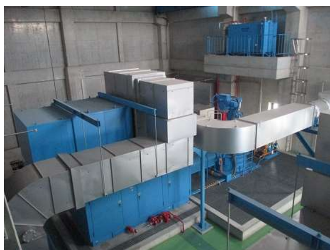
水門ポンプおよび発電設備の風景
